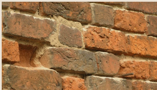
Wykwity i degradacja zapraw to skutek nieodporności zapraw wapiennych w warunkach zewnętrznych.
