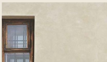
Pałac w Kielcach – zbliżenie fragmentu elewacji. Imitacja charakterystycznego zatarcia tynku barwionego przy użyciu farb laserunkowych Optolith.
