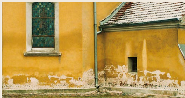
Zniszczenie tynku wapienno-cementowego na cokole spowodowane przez sole mimo wykonania izolacji poziomej.
