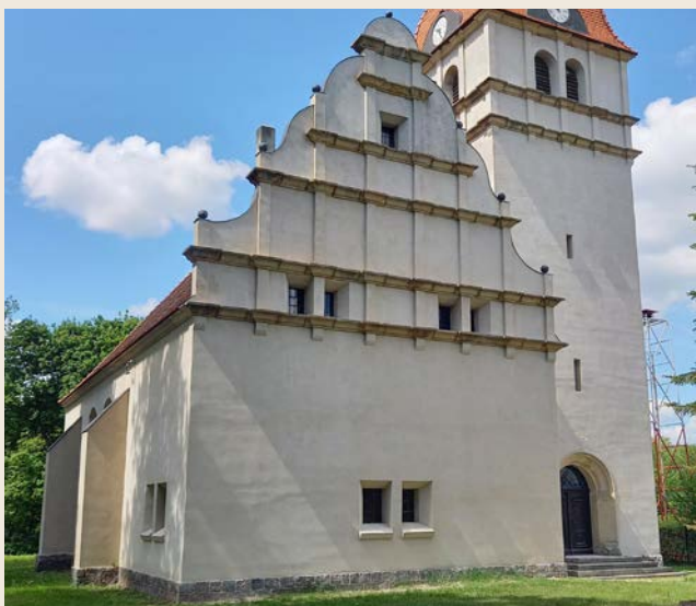
Neorenesansowy Kościół Podwyższenia Krzyża i świętego Andrzeja Boboli w Wałdowie na Kujawach – specjalnie przygotowane w uziarnieniu i kolorze wyrównawcze tynki wapienno-trassowe Optosan RenoPutz i RenoPutz specjal.
