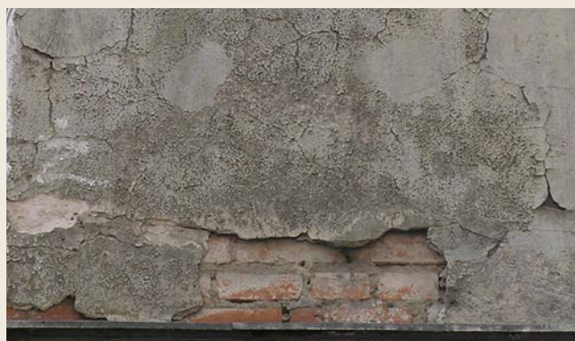
Spękania i rozwarstwienia zbyt mocnego tynku cementowego na słabszym podłożu.
