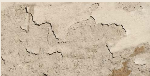
Zniszczenia zaprawy czysto-wapiennej w warunkach zewnętrznych.
