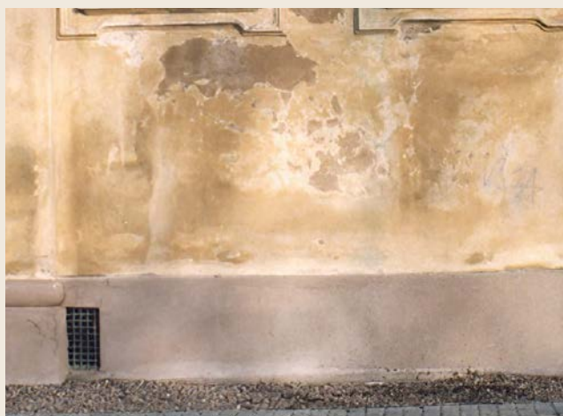
Zniszczenia wywołane przez szczelne i mocne tynki cementowe na cokołach.
