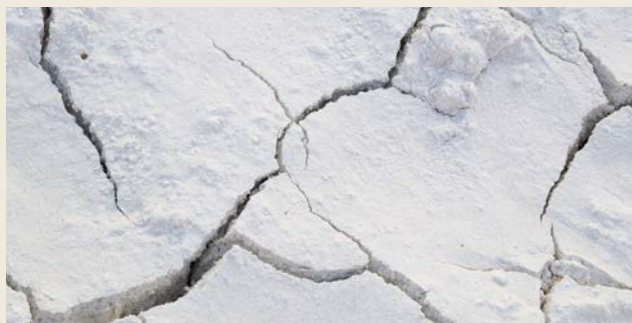
Charakterystyczne rysy skurczowe wapna powietrznego.
